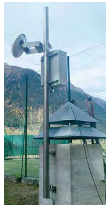
Das Lawinenradar am Tennisplatz der Gemeinde Ischgl mit Blick auf die Großtal-Lawine verfügt über Mobilfunk-Internetanbindung.
