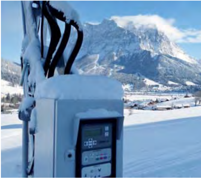
Schaltkasten mit Steuerkonsole.
