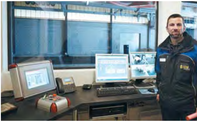
Der Betriebsleiter Paul Käslin im Kommandoraum der Bergstation. Von hier aus wird die Bahn im Normalbetrieb überwacht.
