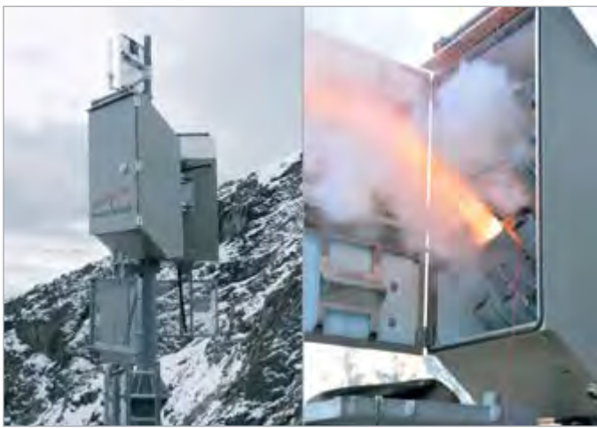
Der Lawinenwächter „schießt“ Wurfladungen direkt in die Lawinen-Anrisszonen. Bis zu 10 Ladungen pro Kasten trägt das System, das im Vorhinein ausgerichtet wird und dank Solarversorgung und Sicherheitsfunk ohne aufwändige Infrastruktur zu montieren ist.
